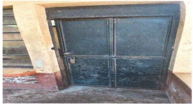
Foto 2: Se observa el deterioro de la pintura de la pared en el area de la cocina.
