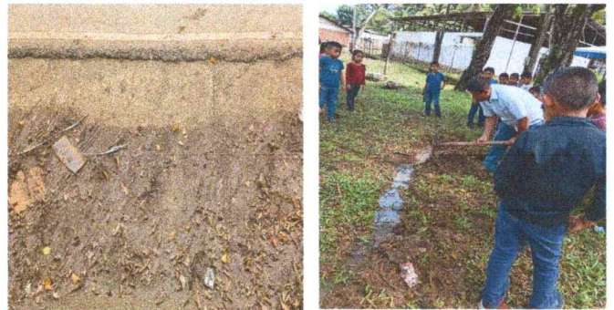
Foto 4: Se observa la aculacion de agua en la entrada del establecimiento por falta de una cuneta.
