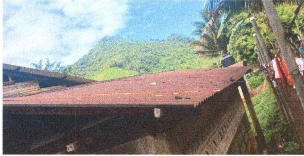
Foto 1: se observa el mal estado y deterioro del techo de la cocina.
