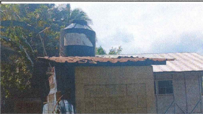
Foto 3: Se observa el baño de niños y niñas en mal estado, tubería dañada y deposito de agua dañado.
