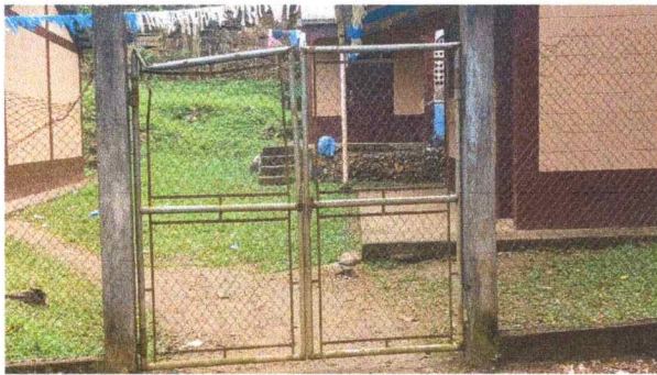
Foto 5: Se observa el mal estado del porton.
